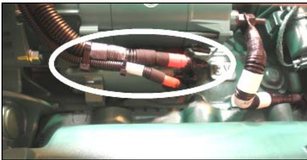
Figure 5: Câbles du démarreur
