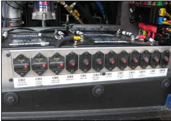
FIGURE 11 : PANNEAU DE JONCTION ÉLECTRIQUE ARRIÈRE
