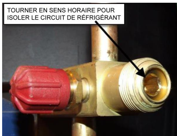
FIGURE 48 : ROBINET D'ARRÊT DU CIRCUIT DE REFROIDISSEMENT
