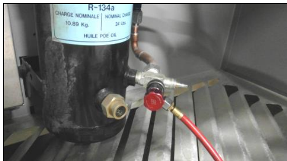
FIGURE 84 : UNITÉ DE RÉCUPÉRATION CONNECTÉE AU ROBINET DE SERVICE DU RÉSERVOIR DE STOCKAGE
