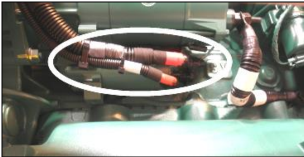
Figure 5: Câbles du démarreur
