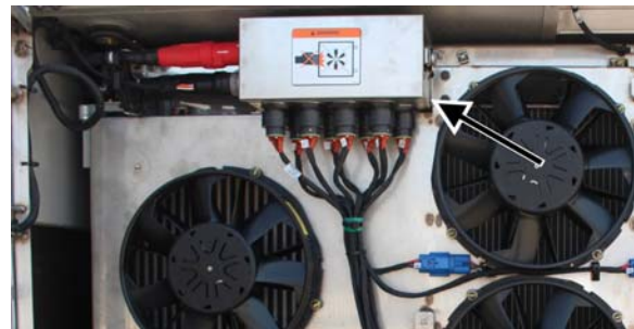
FIGURE 4: BOÎTE DES DISJONCTEURS DES VENTILATEURS DE REFOUILLISSEMENT ÉLECTRIQUES
