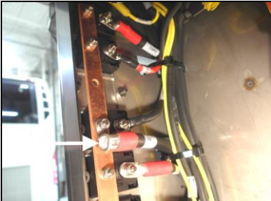
Figure 9: Câble de puissance sur barre omnibus de disjoncteurs principaux
