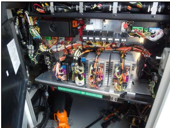
FIGURE 20 : COMPARTIMENT ÉLECTRIQUE ET DE SERVICE AVANT
