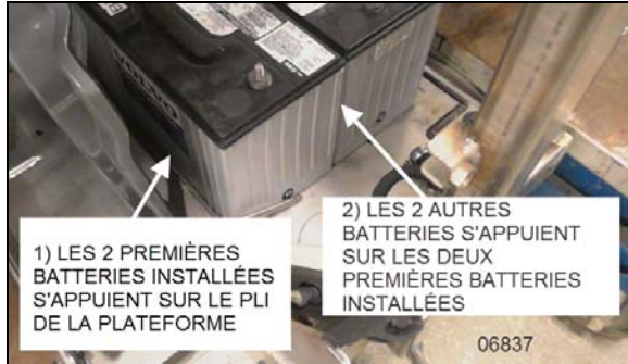
FIGURE 38: POSITION ADÉQUATE DES BATTERIES
