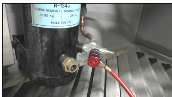
FIGURE 83 : UNITÉ DE RÉCUPÉRATION CONNECTÉE AU RACCORD DE SERVICE DU RÉSERVOIR DE STOCKAGE
