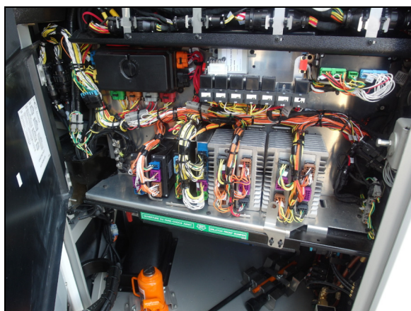
FIGURE 22 : COMPARTIMENT ÉLECTRIQUE ET DE SERVICE AVANT
