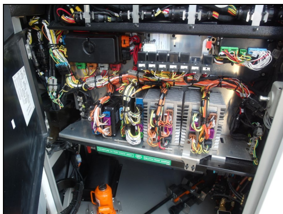
FIGURE 22 : COMPARTIMENT ÉLECTRIQUE ET DE SERVICE AVANT
