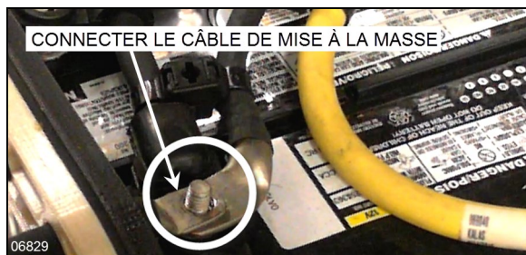
FIGURE 54: Câble DE MISE À LA MASSE
