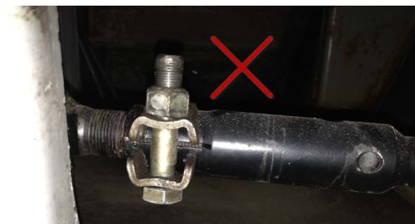
Le collet est déformé. Remplacer le collet.
