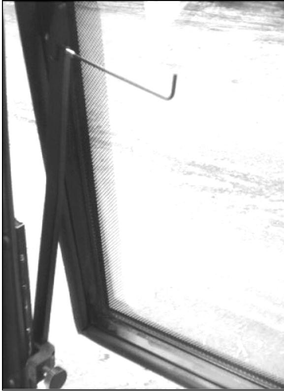
FIGURE 1: DÉCROCHAGE DU BRAS D'ARRÊT SUR LA FENÊTRE
