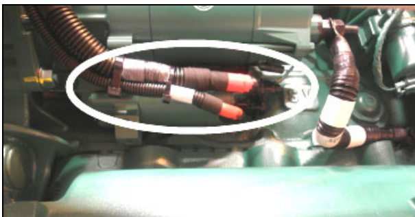
Figure 7: Câbles du démarreur
