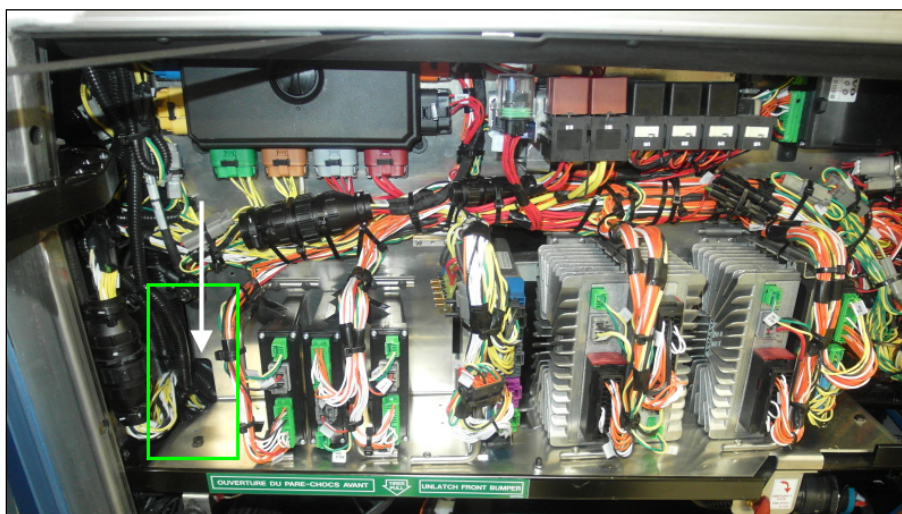
POSITION DU MODULE DANS LA BOITE DE JONCTION (VUE DU H3, X3 SIMILAIRE)
