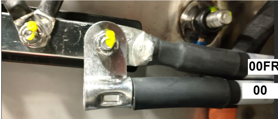
FIGURE 4: INSTALLATION INCORRECTE - LE TERMINAL DU CÂBLE 00FR N'EST PAS PLACÉ SUR LE TERMINAL DU CÂBLE 00
