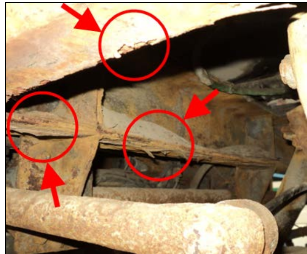
FIGURE 3: ÉCAILLAGE DU MÉTAL ET ACCUMULATION DE SABLE
