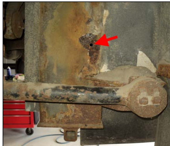
FIGURE 7: TROU PERCÉ DANS LE CHÂSSIS
