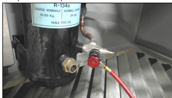
FIGURA 83: UNIDAD DE RECUPERACIÓN CONECTADA AL PUERTO DE SERVICIO DEL SEPARADOR
