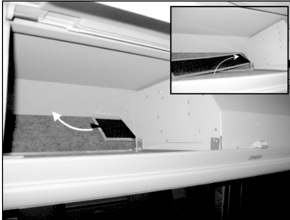
FIGURA 23: FILTRO DE AIRE DE VENTILADOR DE COMPARTIMENTO SUPERIOR
