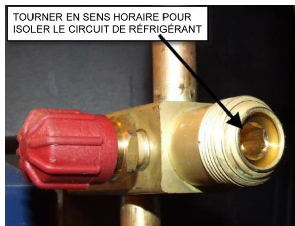
FIGURE 48 : ROBINET D'ARRÊT DU CIRCUIT DE REFROIDISSEMENT
