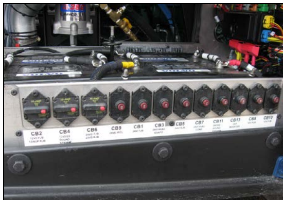
FIGURE 11 : PANNEAU DE JONCTION ÉLECTRIQUE ARRIÈRE
