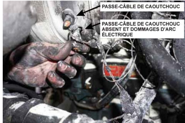
Figure 22: Incendie du compartiment moteur causé par le frottement du câble de puissance sur le boîtier métallique de l'alternateur Bosch T1. Le passe-câble de caoutchouc n'était pas en place au moment de l'incendie. Des dommages causés par un puissant arc électrique sont visibles.
