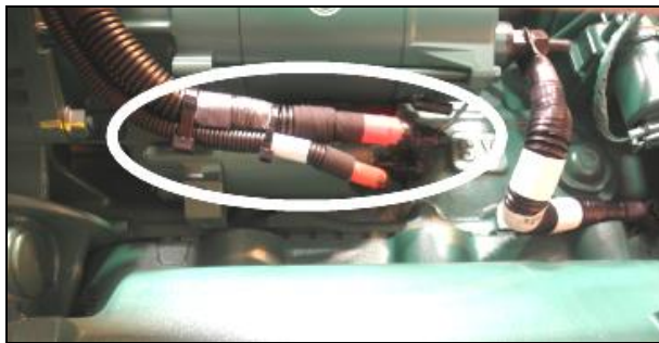
Figure 5: Câbles du démarreur
