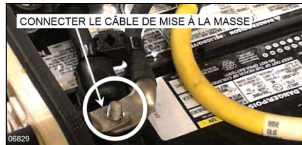
FIGURE 42: CÂBLE DE MISE À LA MASSE
