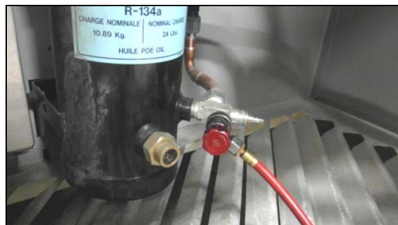
FIGURE 78 : UNITÉ DE RÉCUPÉRATION CONNECTÉE AU RACCORD DE SERVICE DU RÉSERVOIR DE STOCKAGE
