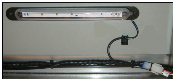
FIGURE 92: MODULES À DEL SCELLÉ
