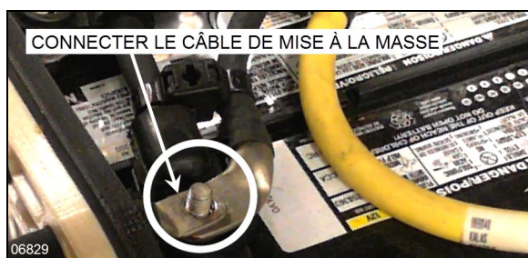
FIGURE 53: CÂBLE DE MISE À LA MASSE
