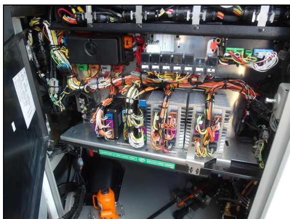
FIGURE 22 : COMPARTIMENT ÉLECTRIQUE ET DE SERVICE AVANT
