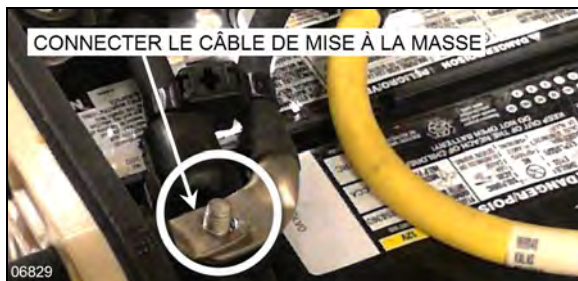
FIGURE 54: CÂBLE DE MISE À LA MASSE
