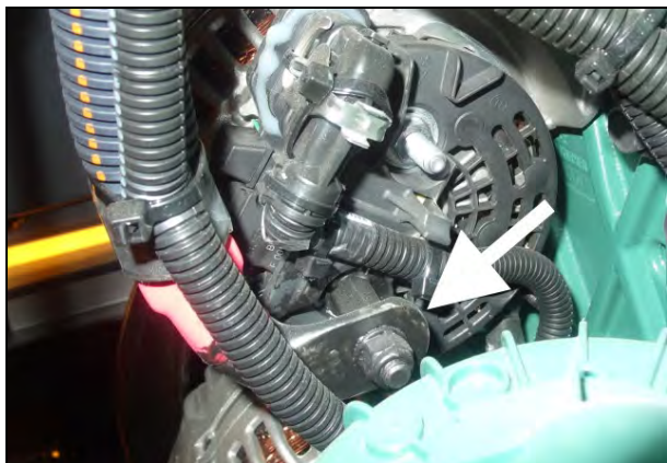
Figure 24: Cosse de câble de l'alternateur supérieur protégé avec le revêtement de protection Color Guard.
