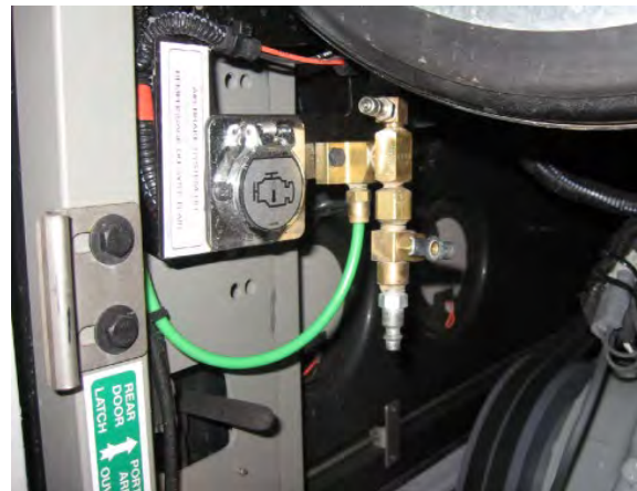
FIGURE 23: VALVE DE REMPLISSAGE DE SECOURS DANS LE COMPARTIMENT MOTEUR
