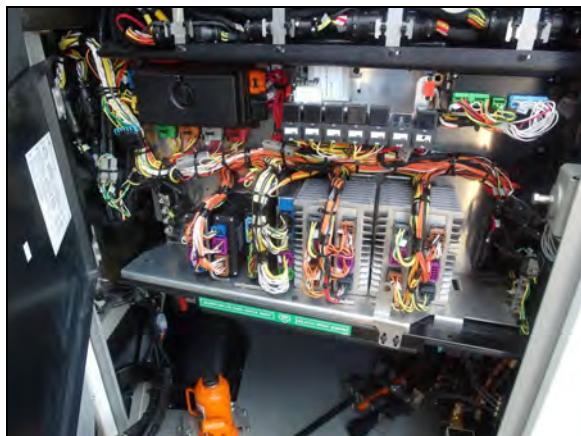
FIGURE 22 : COMPARTIMENT ÉLECTRIQUE ET DE SERVICE AVANT
