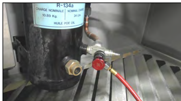
FIGURE 83 : UNITÉ DE RÉCUPÉRATION CONNECTÉE AU RACCORD DE SERVICE DU RÉSERVOIR RÉCEPTEUR
