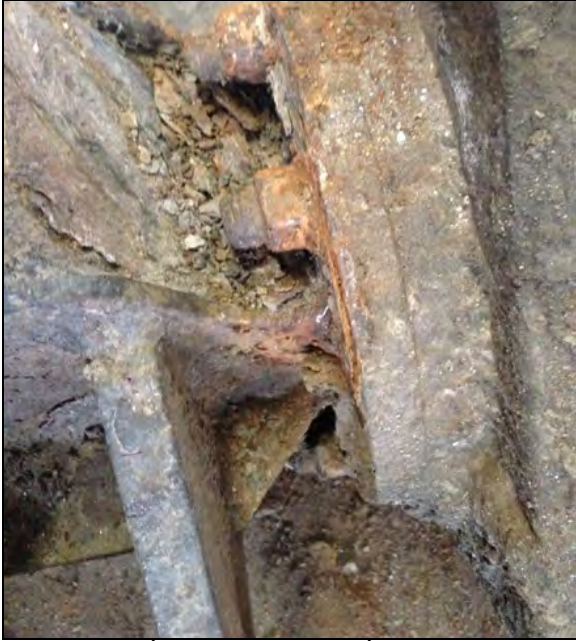
FIGURE 4: ÉCAILLAGE DU MÉTAL SUR L'ESSIEU AUXILIAIRE - DE LA MATIÈRE ACCUMULÉE PEUT RETENIR L'EAU ET CAUSER UN MILIEU PROPICE À LA CORROSION
