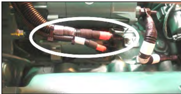
Figure 5: Câbles du démarreur
