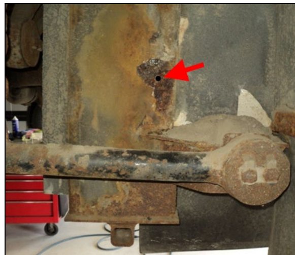
FIGURE 7: TROU PERCÉ DANS LE CHÂSSIS
