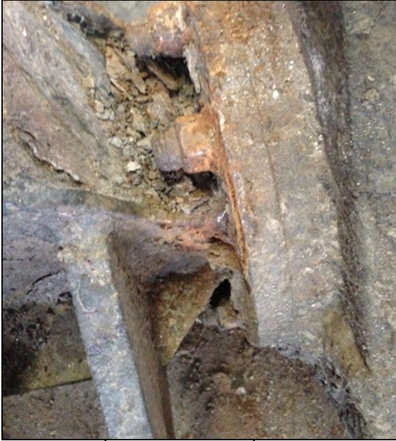
FIGURE 4: ÉCAILLAGE DU MÉTAL SUR L'ESSIEU AUXILIAIRE - DE LA MATIÈRE ACCUMULÉE PEUT RETENIR L'EAU ET CAUSER UN MILIEU PROPICE À LA CORROSION
