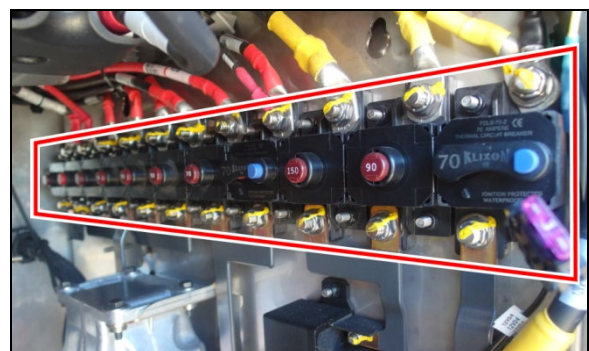
FIGURA 20: INTERRUPTORES DE CIRCUITO PRINCIPALES EN MPC
