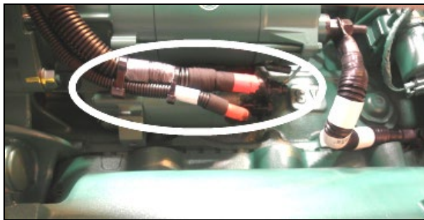
Figure 5: Câbles du démarreur
