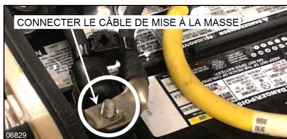
FIGURE 54: Câble DE MISE À LA MASSE
