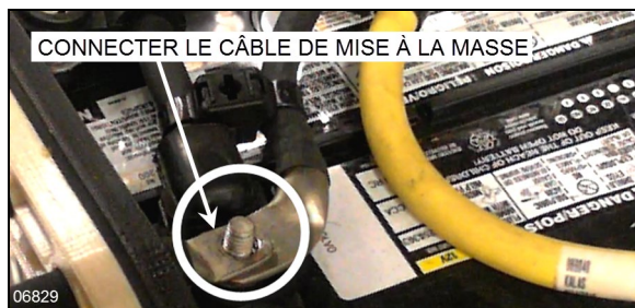
FIGURE 59: CâBLE DE MISE À LA MASSE
