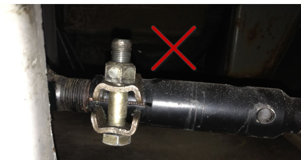
Le collet est déformé. Remplacer le collet.
