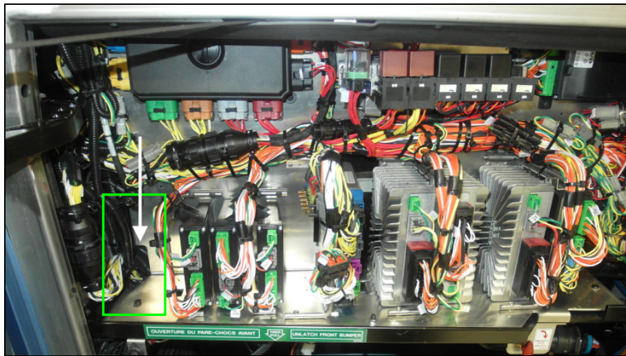
POSITION DU MODULE DANS LA BOITE DE JONCTION (VUE DU H3, X3 SIMILAIRE)
