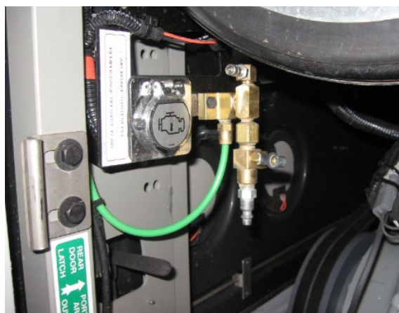
FIGURE 24: VALVE DE REMPLISSAGE DE SECOURS DANS LE COMPARTIMENT MOTEUR
