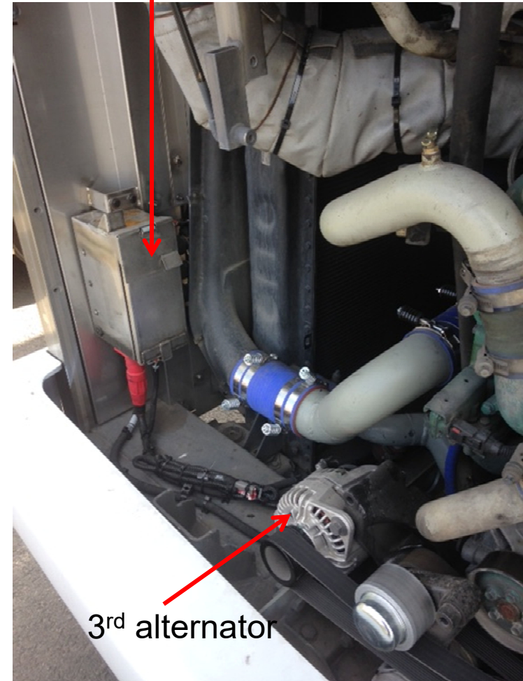
Fan power BOX
