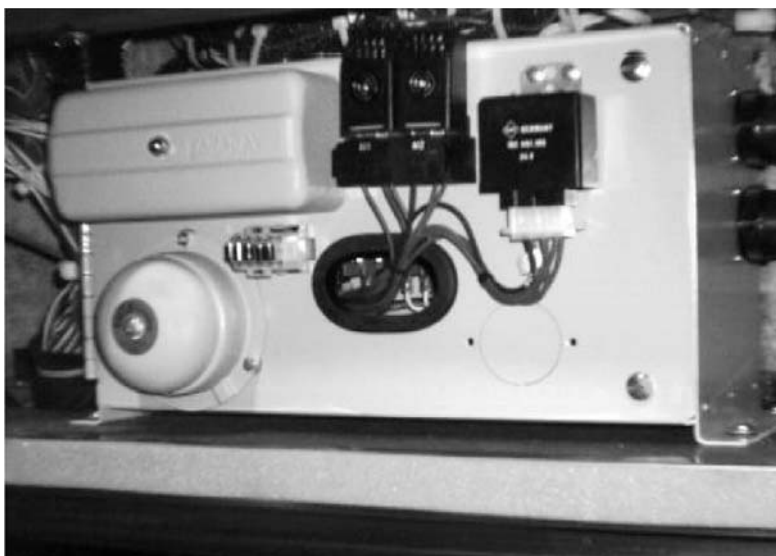
FIGURE 1: BOÎTE DE JONCTION DES ALARMES
