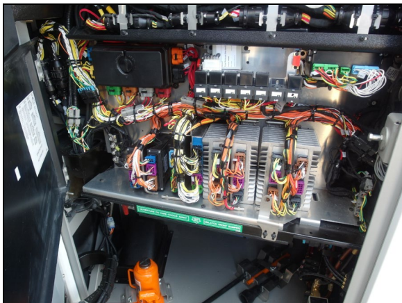
FIGURE 22 : COMPARTIMENT ÉLECTRIQUE ET DE SERVICE AVANT
