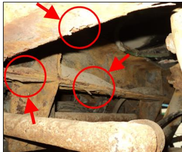
FIGURE 3: ÉCAILLAGE DU MÉTAL ET ACCUMULATION DE SABLE
