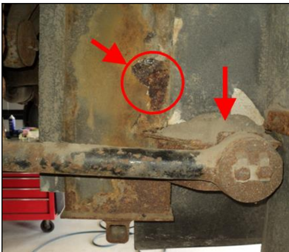
FIGURE 2: ÉCAILLAGE DU MÉTAL. L'ACCUMULATION DE SABLE COMME SUR CETTE IMAGE NE DEVRAIT PAS ÊTRE LAISSÉE EN PLACE
