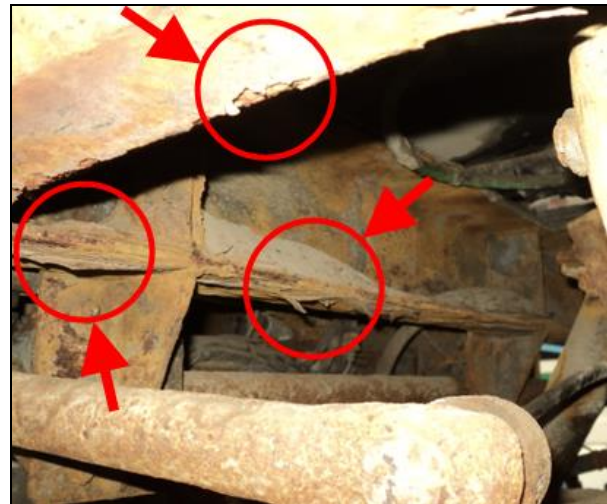
FIGURE 3: ÉCAILLAGE DU MÉTAL ET ACCUMULATION DE SABLE
