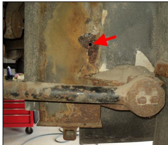
FIGURE 7: TROU PERCÉ DANS LE CHÂSSIS
