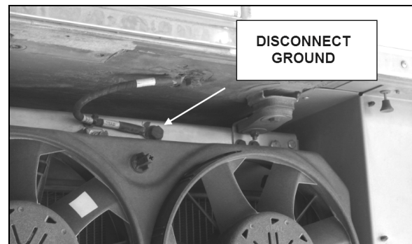
FIGURA 32: TIERRA DEL CONJUNTO DE ENFRIAMIENTO
